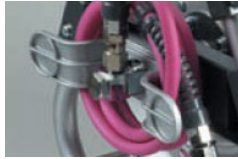
一次側接続部
