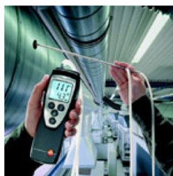
ピトー管を接続して、ダクト内の風速を計測
