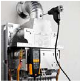
煙道にプローブを差込 ドラフト圧を測定
