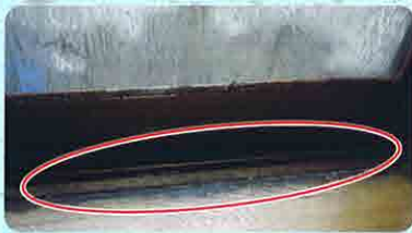
床面に垂れ落ちた水分によって汚れが付着
