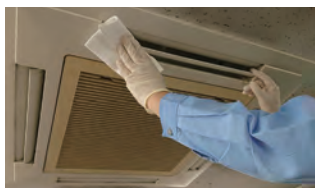
吹出し口やルーバー
