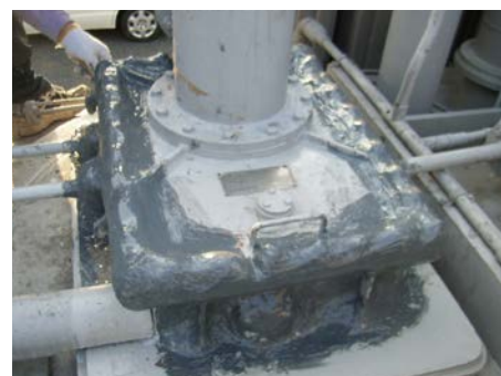
変圧器フランジ部漏油防止
