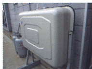
オイルタンク
