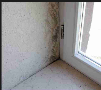
気密不足によるカビ発生の様子
