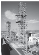
屋外試験鉄塔群
