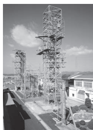
屋外試験鉄塔群
